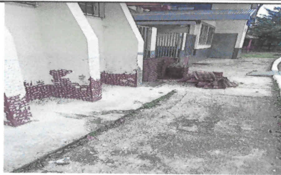
Foto 2: Pintura exterior área de biblioteca, paredes en la parte exterior de biblioteca necesitan remosamiento para la protección de paredes zocalo y azulejo.
